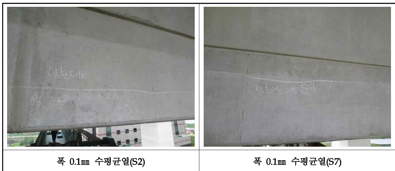
【사진 3.2.2】 거더 외부 손상현황(대구)
