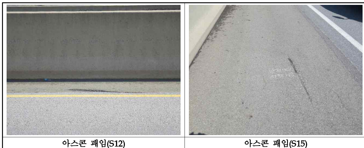
【사진 3.3.16】 교면포장 손상현황(부산)
