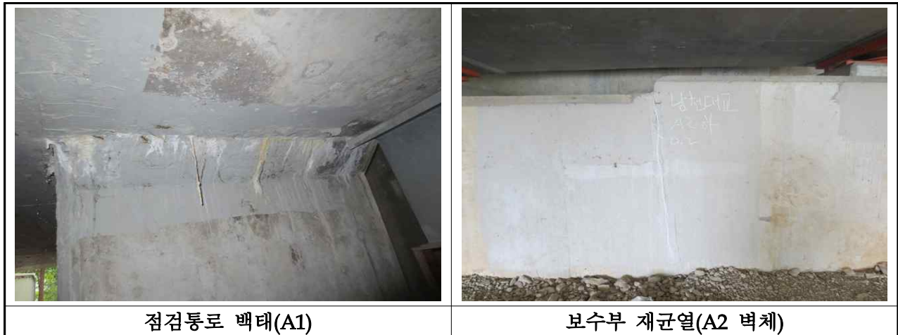
【사진 3.3.6】 교대 손상현황(부산)
