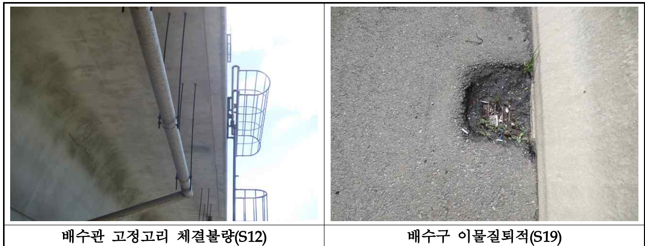
【사진 3.3.18】 배수시설 손상현황(부산)
