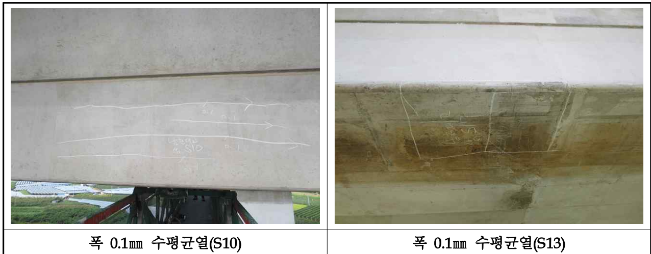
【사진 3.2.2】 거더 외부 손상현황(대구) - 계속
